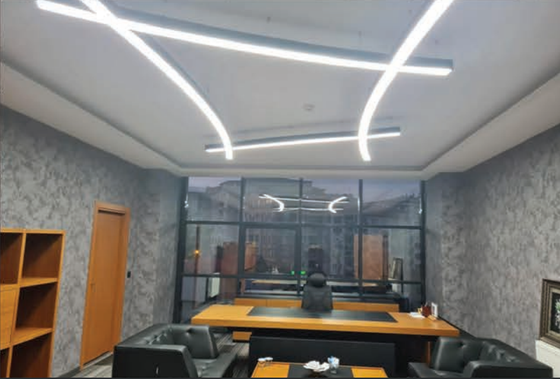
Sivas - Buruciye A.Ş. Sivas Valiliği İştiraki Yönetim Binası Genel Aydınlatması
