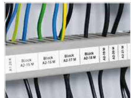
Kablo Kanalı Üzerindeki Şerit Etiketler
